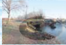
Erosion de la berge en amont du pont de Marsac rive gauche.
