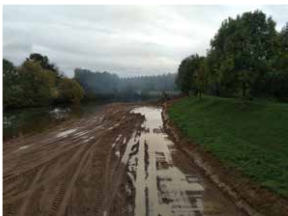
Atterrissement d'alluvions en rive gauche avec aggravation du risque d'érosion dans la traversée de Tasque
