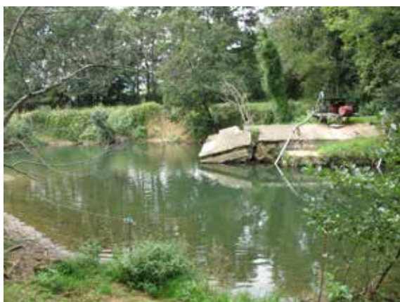
Vestiges d'une ancienne digue et érosion de berge à proximité d'une voirie
