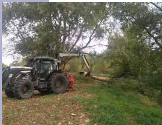
Recepape préventif en aval de Chelle Débat
