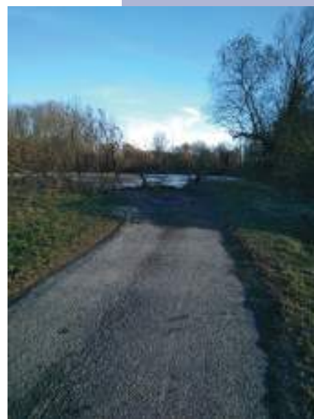
Vue de l'aval de l'érosion après la crue de décembre 2021
