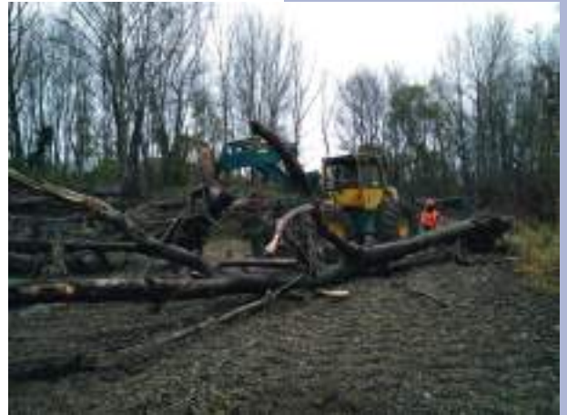
Exemple de gestion d'un embâcle à Cahuzac sur Adour : façonnage des bois hors d'eau
