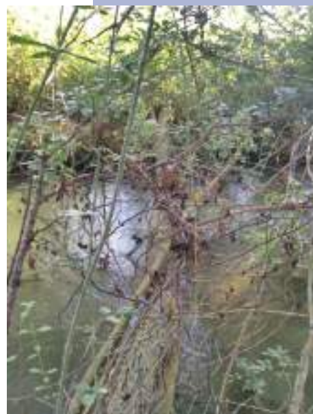
Embâcle amont vanne Lauzue - Sauveterre
