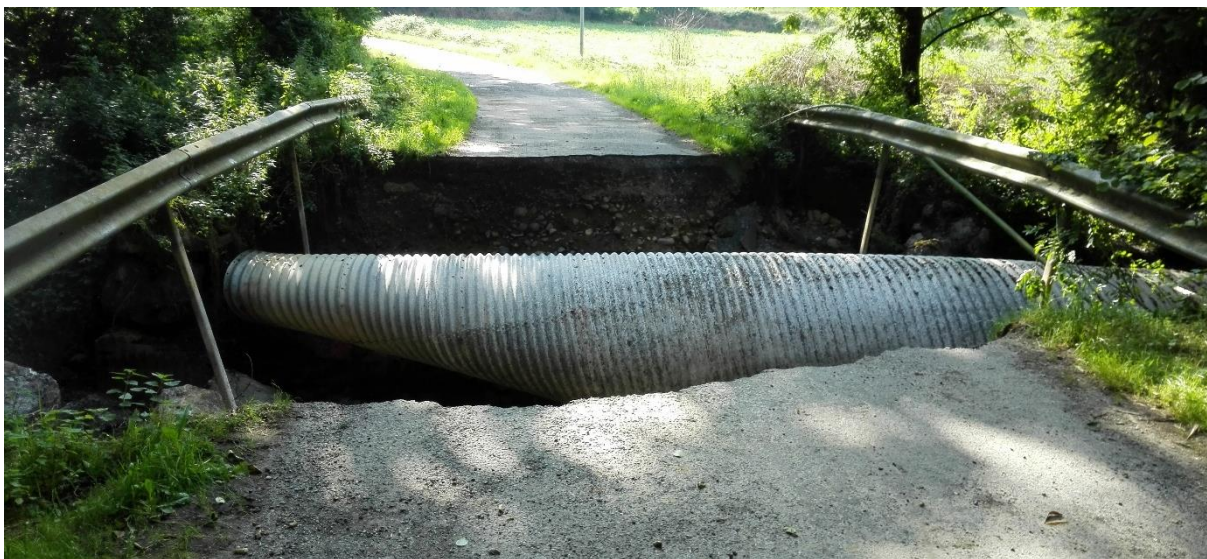
Pont détruit sur le Louet sur la commune de Séron suite à la crue du 12 juin 2018
